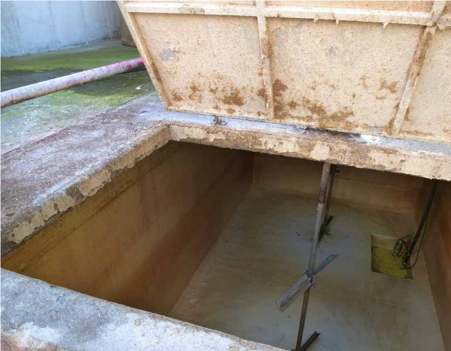
Das in einem Erdtank gelagerte Nebenproduktegemisch musste komplett entsorgt werden.
